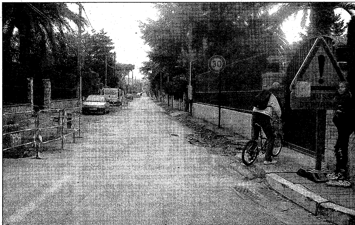
La rue de la Vigne est en chantier jusqu'au printemps. Elle reste ouverte à la circulation quand les travaux l'y autorisent. (Photo L.L.)
